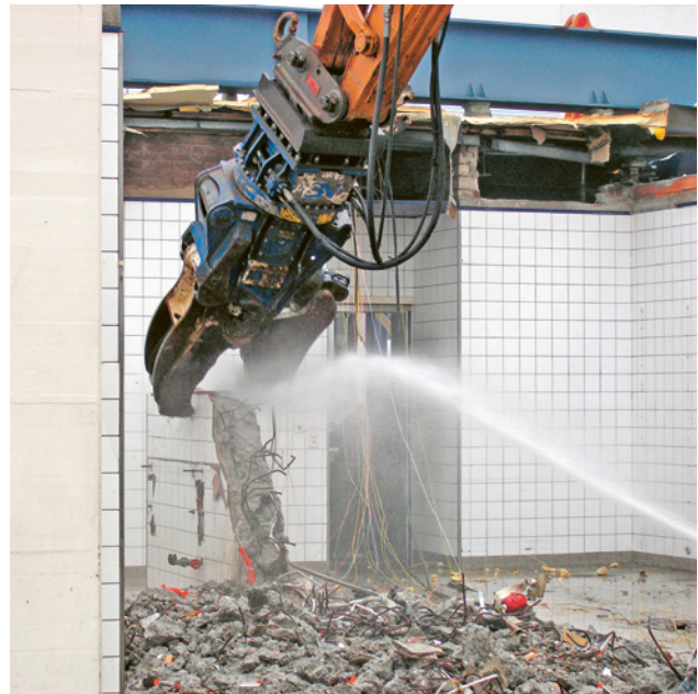
Keramikplatten mit asbesthaltigem Plattenkleber
