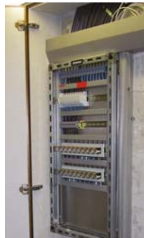
1 Asbesthaltige Leichtbauplatten, z. B. als Brandschutzverkleidungen im Inneren von Elektroschrank, hier Türverkleidung
