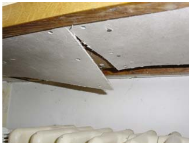
3 Asbesthaltige Leichtbauplatten als Brandschutzverkleidungen, z.B. bei Radiatoren
