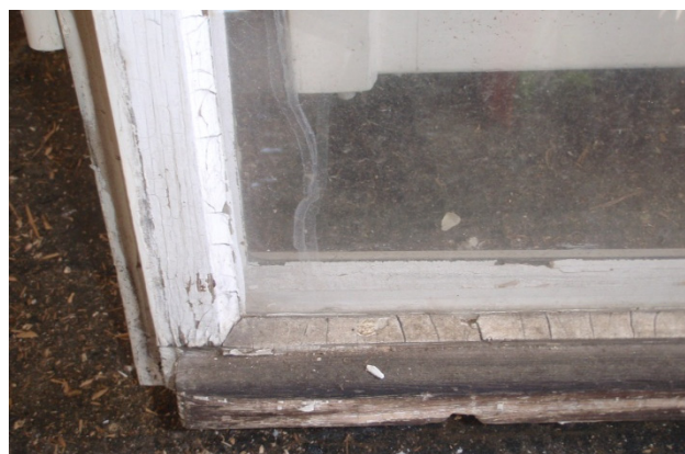
1 Asbesthaltiger Leinölkitt an einem Holzfenster
