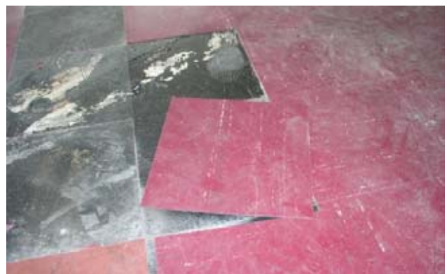
1 Bei einschichtigen Floor-Flex-Belägen (hart und brüchig) ist der Asbest im Kunststoff festgebunden.
