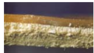
2 Dreischichtiger Cushion-Vinyl. Die unterste Schicht enthält über 40 Prozent Chrysotilasbest.
