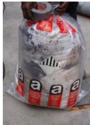
6 Kunststoffsack mit der Kennzeichnung «Asbest»
