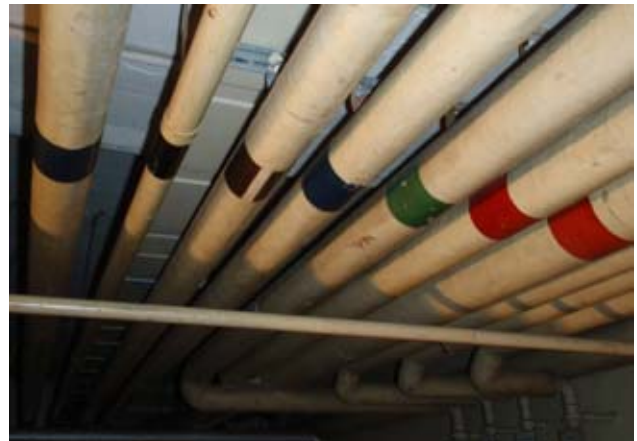
1 Rohrisolation mit asbesthaltiger Gipsbandage
