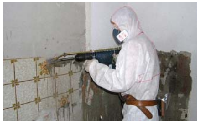
1 Platten mit asbesthaltigem Kleber müssen mit einem Kangohammer mit Wassersprüheinrichtung nass entfernt werden.
