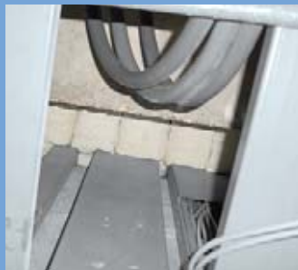
Brandabschottung mit Asbestkissen
