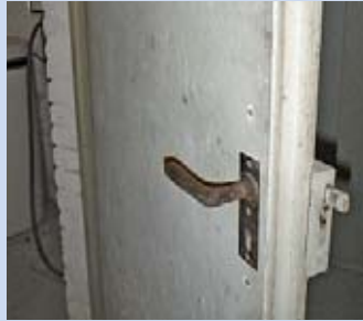
Brandschutztüre mit Asbestzement
