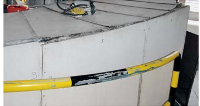
asbesthaltige Dämmung hinter einer Verkleidung
