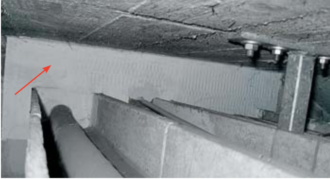
Kabeldurchbruch mit Brandabschottung
