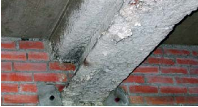
Spritzasbest an Stahlträger
