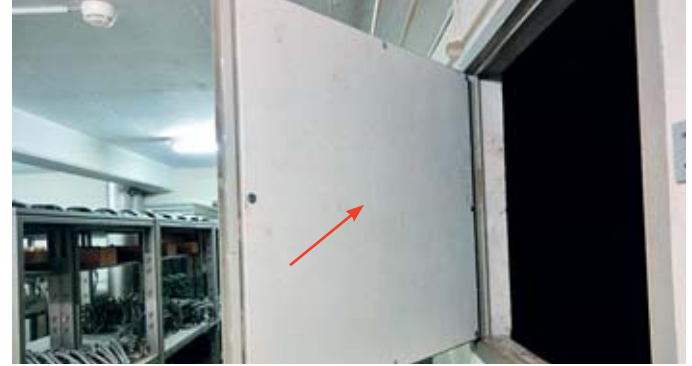
Brandschutz an Türe
