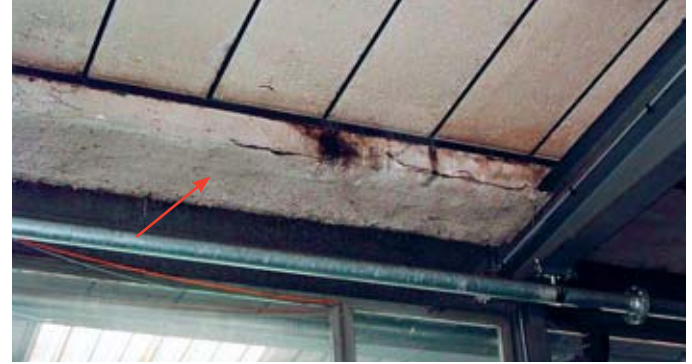
Spritzasbestisolation an Dachkonstruktion
