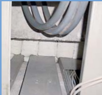
Brandabschottung mit Asbestkissen
