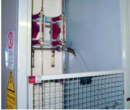
Brandschutzplatte als Trennwand
