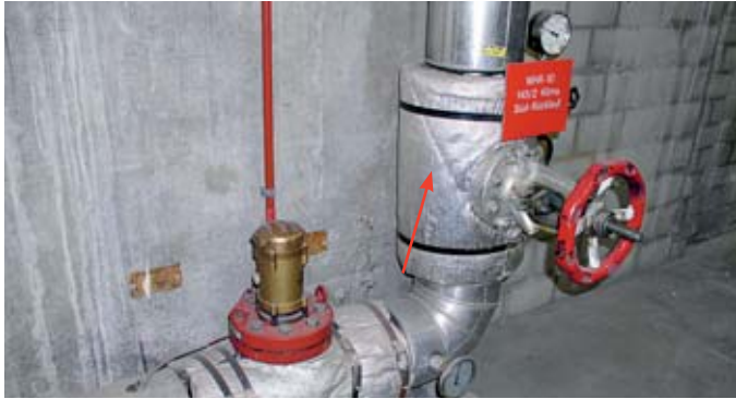
Isolationsschale für die Hitzeisolation
