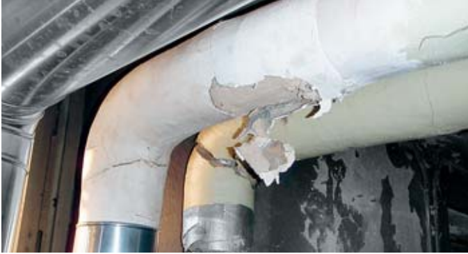
Rohrleitung mit asbesthaltigem Mörtel
